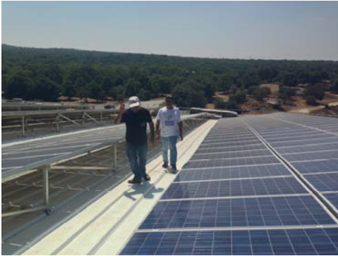
(写真6) リンゴ貯蔵庫屋上にある太陽光発電機
